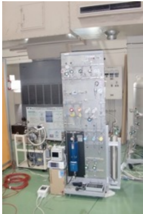
ガスハンドリングパネル
